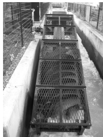
小水力発電所の現状を確認 （あじさい公園）
