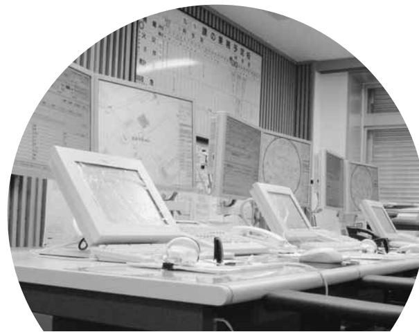
▲新しく導入された消防緊急通信指令システム
