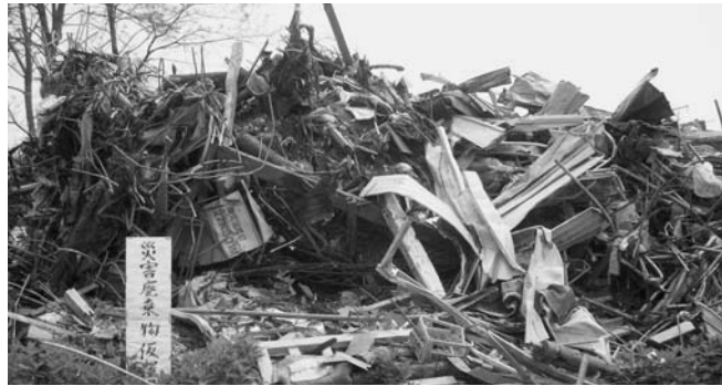
撤去された瓦礫
