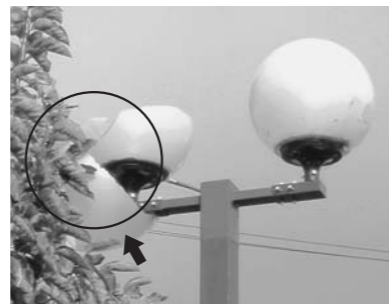
壊された開成駅前公園の公園灯
