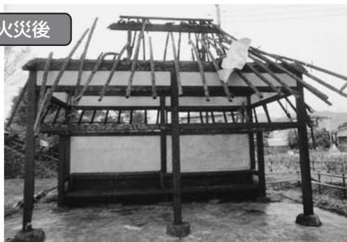
昨年11月に火災により焼失したあじさい公園休憩所
