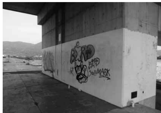
消した後に落書きをされた足柄大橋下橋脚
