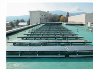
開成小学校の太陽光発電設備
