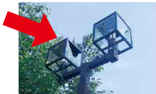
割られた照明灯カバー
