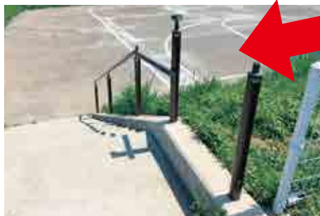
壊された手すり
