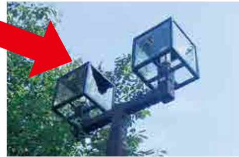
割られた照明灯カバー
