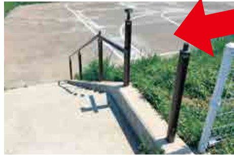
壊された手すり
