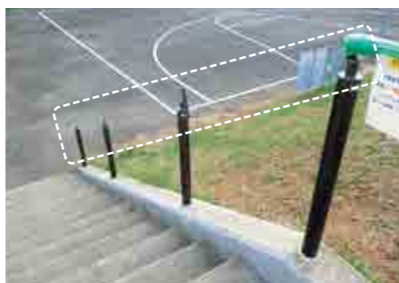
▲壊れてしまった階段の手すり
