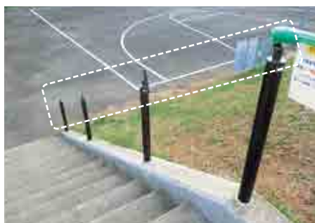
▲壊されてしまった階段の手すり
