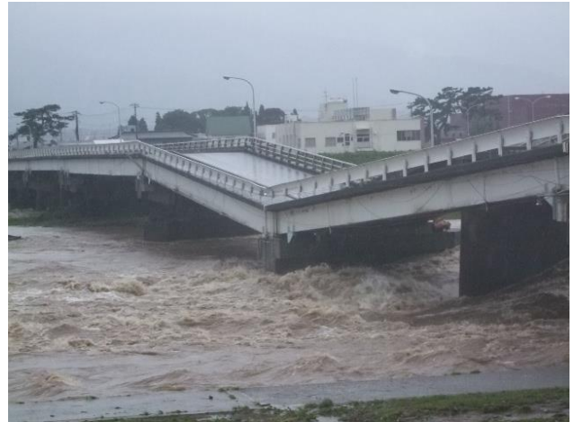
図6-10 台風による十文字橋落橋 (平成19(2007)年)
