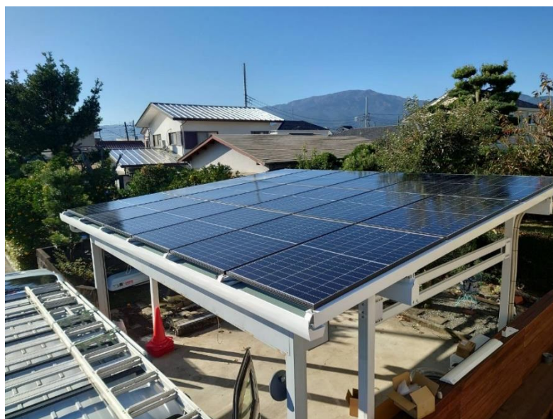
図 3-12 町内のソーラーカーポート (補助金活用事例)
